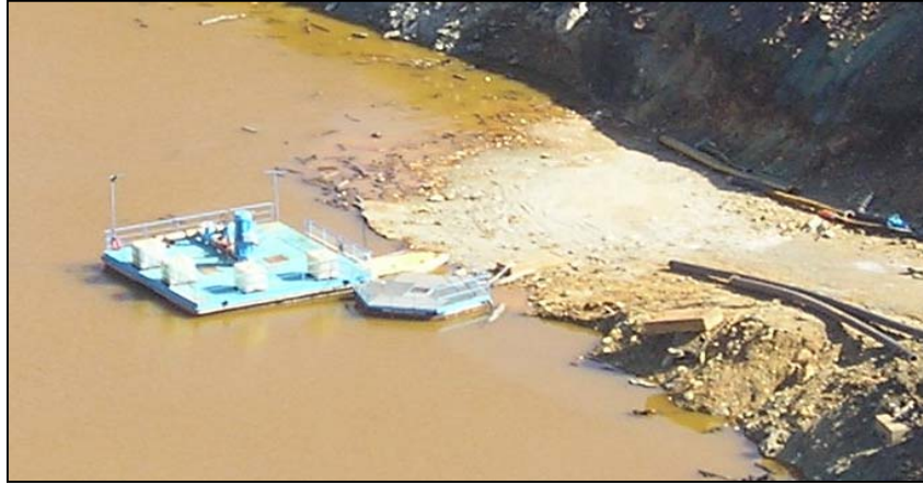
Figura 7.7. Situación de la balsa de bombeo después del derrumbe de la plataforma de vertido, se observa los tubos de bombeo cortados además de un incremento de la cota de lámina de agua.
